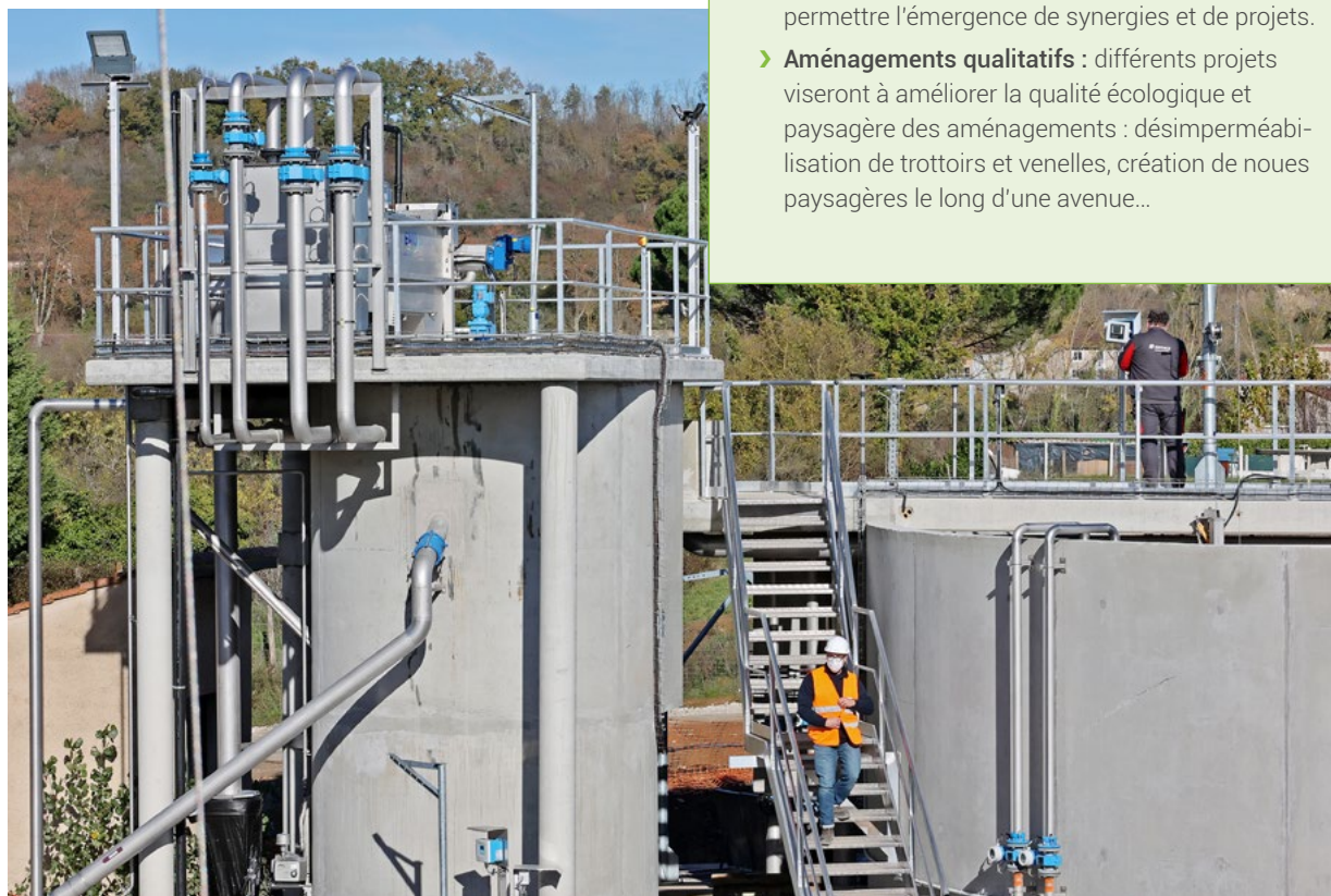
Nouvelle station d'épuration à Marssac-sur-Tarn
