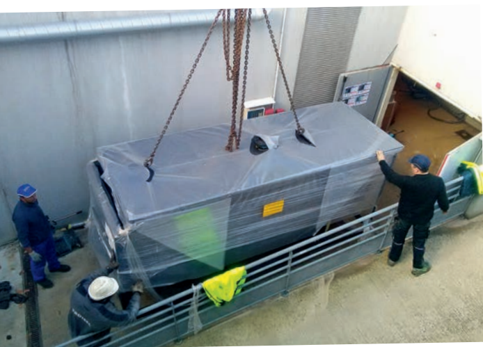
La deuxième chaudière a été livrée en novembre.
