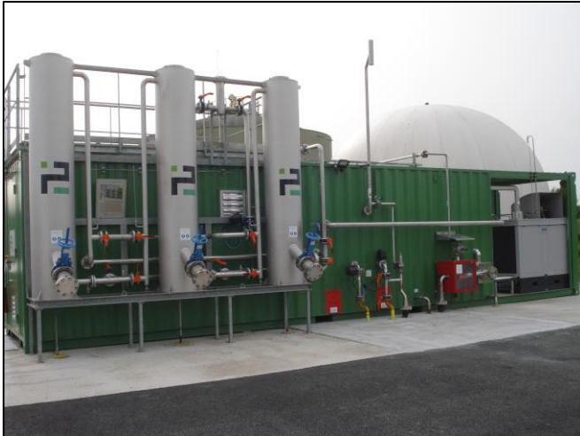
Unité de traitement du biogaz et de transformation en biométhane
