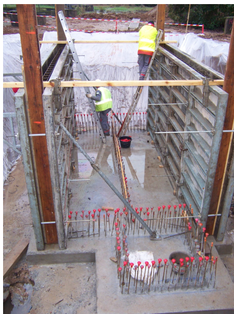
Bassin tampon et canal de comptage débitmétrique- Secteur La Vène
