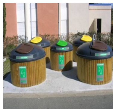
Conteneurs semi-enterrés avec OMR
